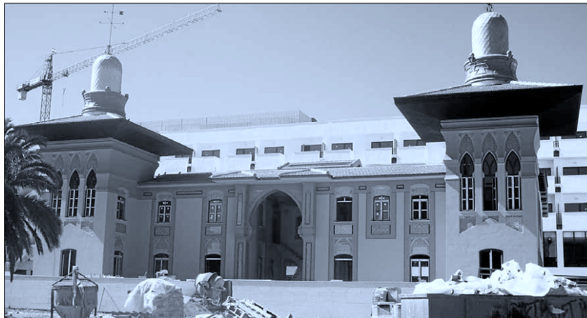
■ El Gran Hotel Palacio de la Marina de Mojácar sigue sin estrenarse después de seis años de su construcción. / LEÓN
