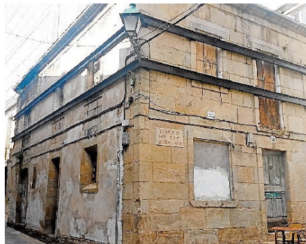
Un inmueble en estado deficiente en el casco histórico
